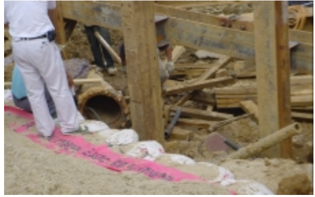
사진 2. 손상된 매설관 조인트 부
