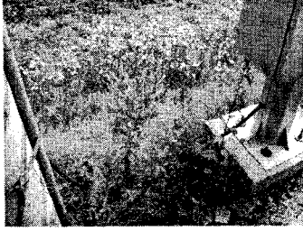
그림 3 노출된 가로등 인입선 Fig 3 Exposed service wire
