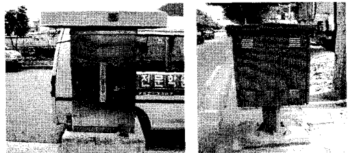
그림 7 분전반외함의 절연상태 Fig 7 The insulation condition of panelboard
