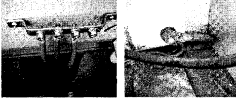
그림 8 분전반의 접지시공상태 Fig 8 The grounding condition of panelboard
