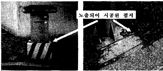
그림 9 노출된 접지선 Fig 9 The exposed grounding wire
