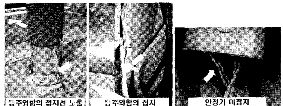
그림 13 잘못 시공된 접지 Fig 13 The mistaken ground wire
