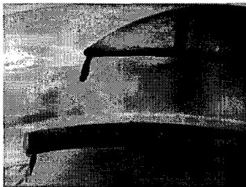
Fig. 17 Rib plate crack
