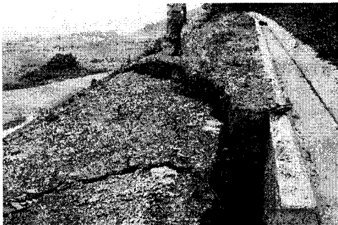
그림 3. 굴착중 산마루측구에 인장균열 발생
