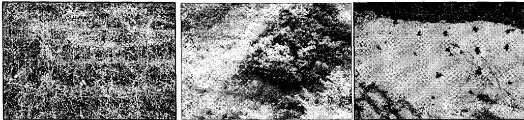
사진 2. 산사태 녹화공의 양호한 상태(좌: 7급줄떼공, 중: 식재공)와 불량한 상태(우: 7급줄떼공)
