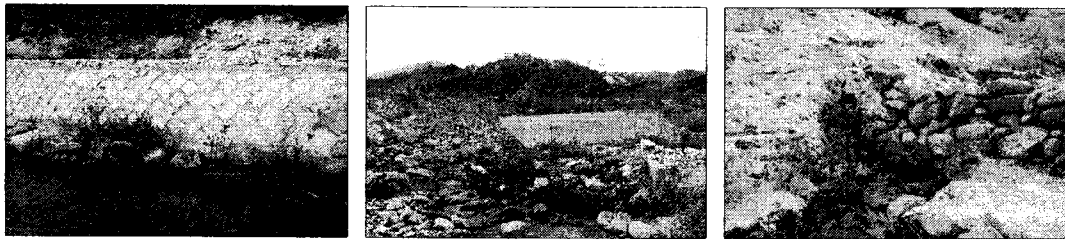
사진 4. 기슭막이와 바닥막이의 양호한 상태(좌: 콘크리트 기슭막이)와 파손상태(중: 콘크리트 바닥막이, 우: 돌망태기슭막이)
