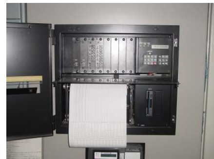
그림 3. 고장기록장치(TR-2132) Fig. 3. Fault Recorder(TR-2132)
