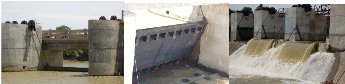
그림 11. 자동전도식(Automatic Tilting Gate) 수문 설치 사례 (캄보디아 Dam Nak Ampil 등 다수)
