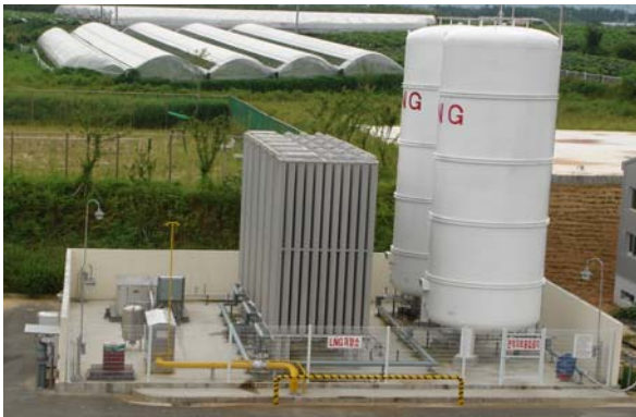
Fig. 8 LNG 저장 설비
