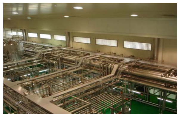
Fig 11 전처리실 UTILITY 배관
