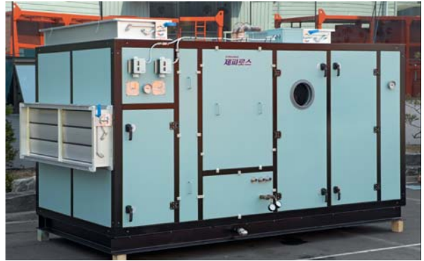
사진.3 Air handling unit
