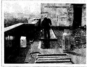
사진. 6 토치공법 시공 문제
