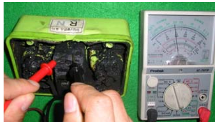
〈그림 2〉 소손된 차단기 1차측 극간 저항 측정
