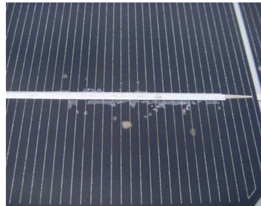
그림 5) 옥외 노출된 PV module의 전극부식
