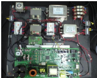
그림 3. 인버터 시스템 Fig. 3. Inverter system
