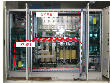
그림 2 제작된 2MVA 수냉형 PCU 모습외형
