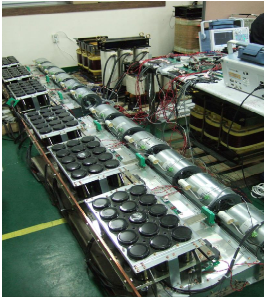
그림 3 500kW급 풍력발전기용 전력변환 시스템 Fig. 3 500kW Wind Turbine Power Conversion System
