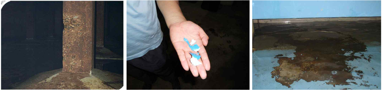
그림 3. 오존에 의한 콘크리트 및 방수/방식재의 열화
