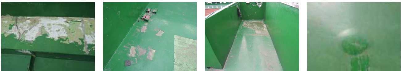
그림 1. 기존 옥상 방수공법의 하자 사례
