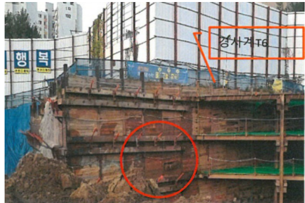
Fig. 2. 흠막이 가시설의 토류판 파손
