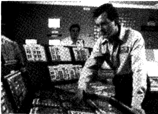
▲美國 Salem 原子力發電所의 中央制御室.
