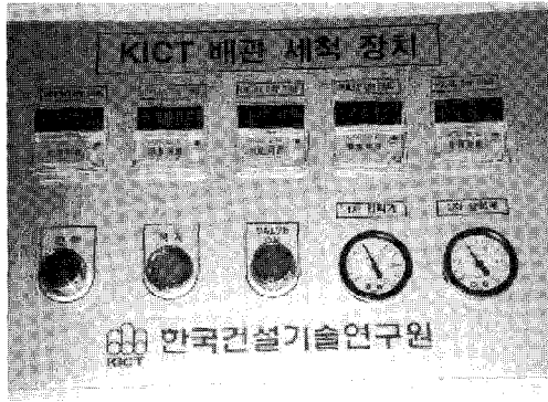
〈그림 6〉 배관세척장치의 Switch Board
