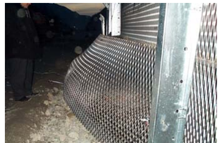
(b) 익스팬디드메탈 낙석방지울타리 손상
