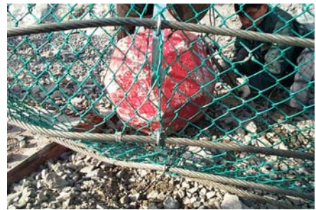
(a) 와이어로프+철망 낙석방지울타리 손상
