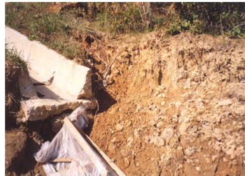
그림 5. 과도한 침식에 의한 산마루측구 붕괴
