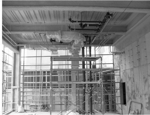
지하2층 화장실 오배수배관
