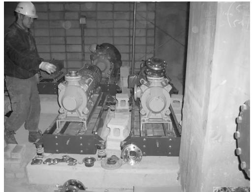
지하2층 기계실 급수 PUMP 배관
