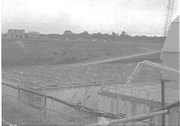
원연 시설 내의 저준위 폐기물 처리장. 저준위 폐기물이 시멘트와 섞여 드럼에 채워지면 지하에 마련된 폐기물 처리장에 차곡차곡 쌓이게 된다.
