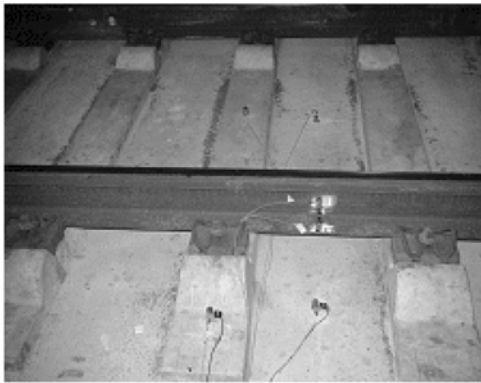
(c) 레일, 침목 등에 설치된 가속도계(콘크리트 슬래브궤도)
