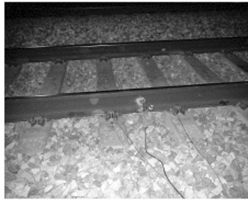
(b) 레일, 침목 등에 설치된 가속도계(자갈도상궤도)
