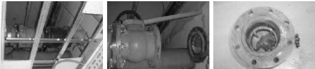
(1) 지하층 천정속 연결송수구 관로 (2) 문제의 체크밸브 철거 (3) 체크밸브 내부에 이물질 끼어있음
