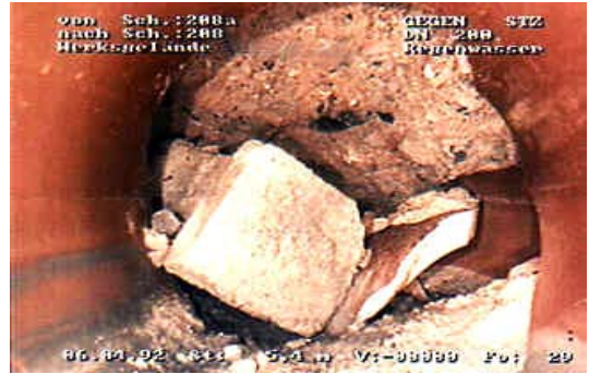
Fig. 3 흙관의 파손, 붕괴
