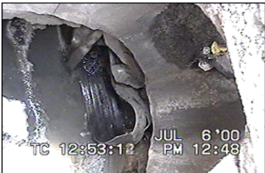
Fig. 2 콘크리트 연결관의 함몰
