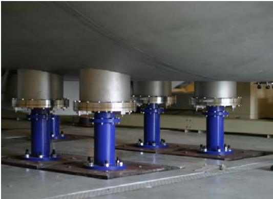
그림 25. 방진계가 설치된 챔버 바닥 연결부
