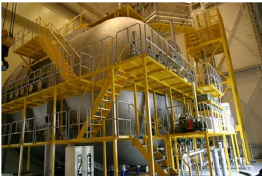
그림 31. 대형열진공챔버 기계실 측면 모습
