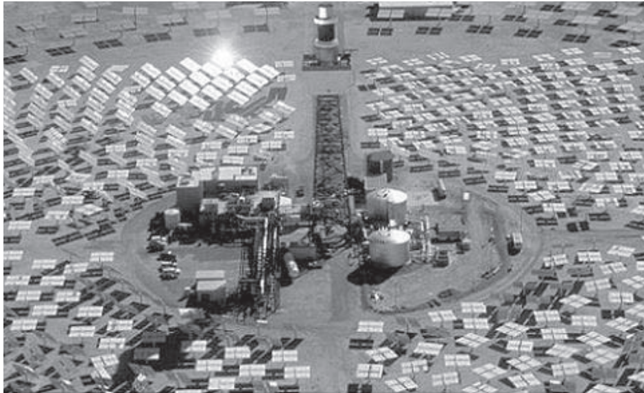
▲ 미국 캘리포니아에 설치된 10MW급 태양열발전시스템
