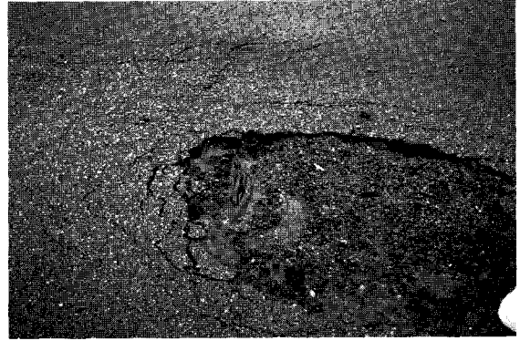
그림 1. 교면포장의 파손 예
