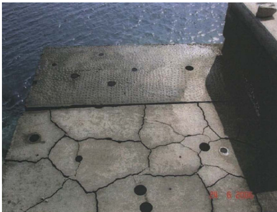
그림 1. 중동지역의 DEF(Delayed Ettringite Formation)에 의한 균열발생 사례
