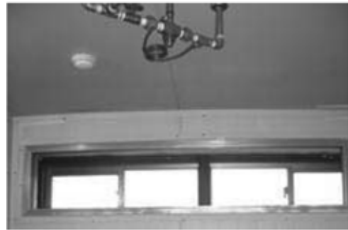
(b) Exhaust (vent 3)
