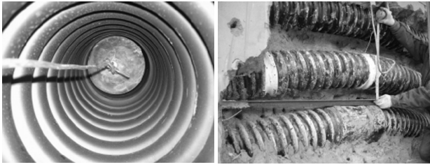
그림 11. 부력에 의한 관로 변형(좌측 : 관로변형 정면 도통시험, 우측 : 관로변형 측면)
