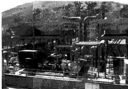
Fig. 2 시멘트공장 폐열이용 스팀터빈 발전설비
