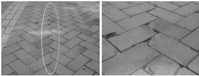
그림 3. 모서리 깨짐 파손 (2)
