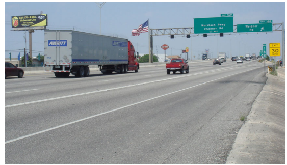
그림 4. 노후 CRCP에 덧씌우기 된 고무 아스콘의 6년 후 모습
