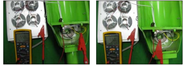
(a) 컨버터 1차측과 외함의 절연저항 측정(500Vdc 인가)
