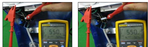
(a) 컨버터 1차측 단자와 외함 간의 절연 측정
