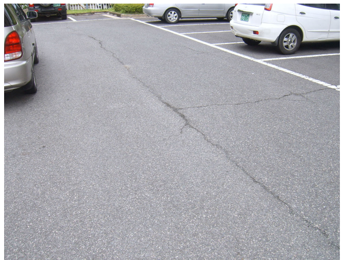
그림 2. 종방향 균열(경산남도, 부산 1)
