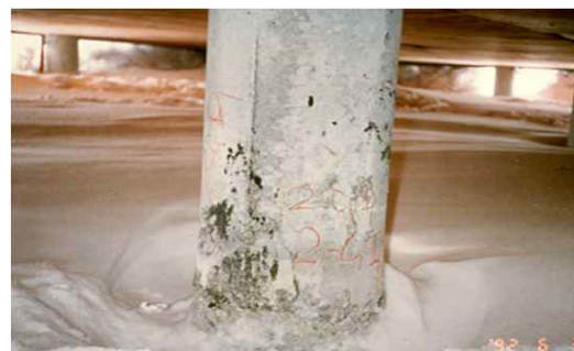
사진 1. 동해 후 화학적 침식을 받은 콘크리트구조물의 복합적 성능저하
