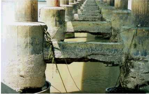
사진 2. 해수의 화학적 침식 및 염해를 받은 콘크리트구조물의 복합적 성능저하
