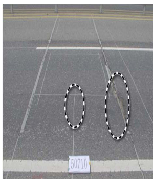
Piezo 및 Loop 센서 파손
