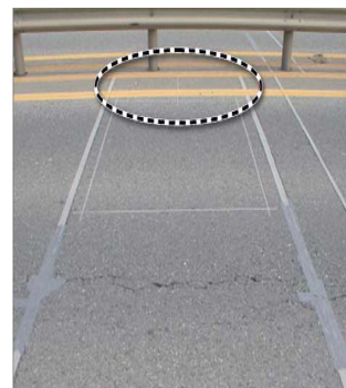
중앙분리대 이전으로 인한 센서 위치 불량
