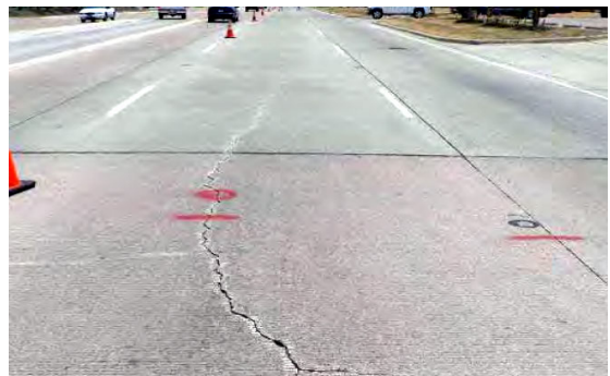
(a) 종방향 균열
