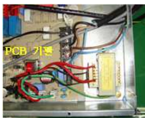
그림 4. 제어반 내 설치 사례 Fig. 4. Case of installation at Control box
