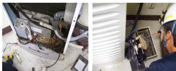
(a) 에어컨 내부 퇴적물 (b) 배수펌프 집수통 내 이물질
