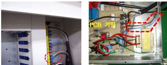
(a) 접지 미결선(절단됨) (b) 미 접지 상태
