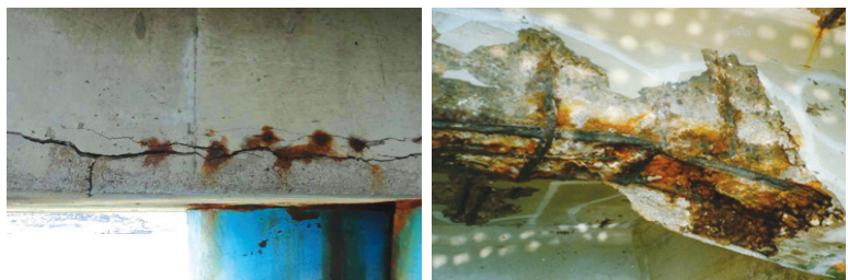
사진 1. 염해에 의한 철근 부식 및 콘크리트의 균열
