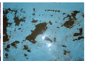
사진 4. 방수·방식재 열화 현황
