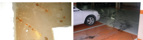
사진 7. 지하구조물 바닥에서의 누수사례
