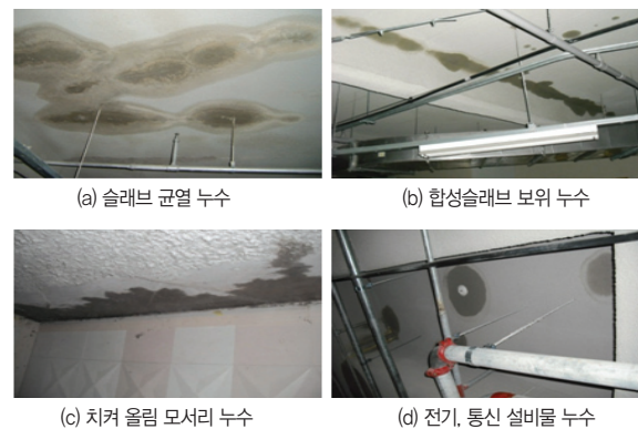
사진 4. 지하구조물 천정에서의 누수사례
