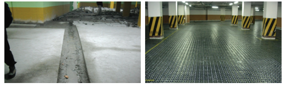
사진 8. 바닥에서의 누수보수 사례
