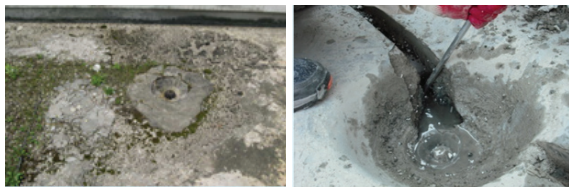
(a) 드레인 주변 누름층 동해 (b) 누름층 하부 물고임
