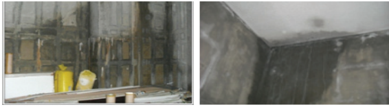
(a) 콘크리트 이음타설 누수
