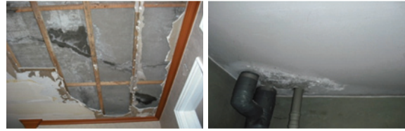
(a) 화장실을 경유한 하부층 거실천정 누수 (b) 배관 슬리브 틈새를 관통하는 천정 누수
