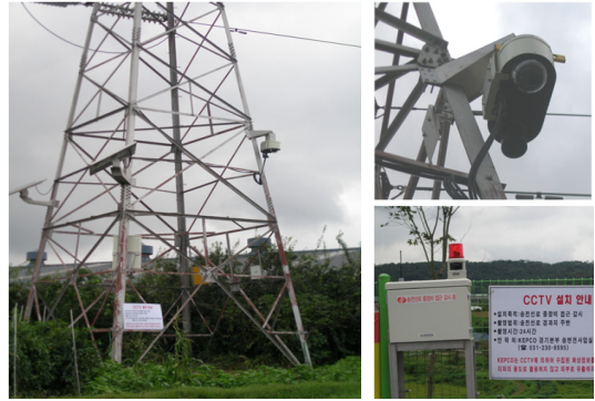
〈그림 11〉 pilot 시험을 위한 경기본부 설치 (Fig. 11) Installing the Gyeonggi headquarter of KEPCO for pilot test.
