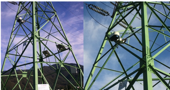
〈그림 10〉 pilot 시험을 위한 경기북부분부 설치 (Fig. 10) Installing the north gyeonggi headquarter of KEPCO for pilot test.
