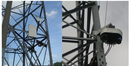
〈그림 12〉 pilot 시험을 위한 부산본부 설치 (Fig. 12) Installing the Busan Headquarter of KEPCO for pilot test.
