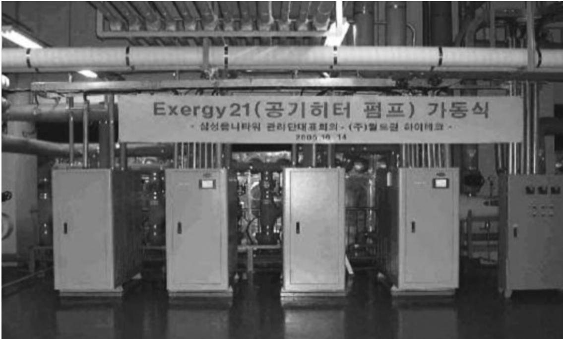
(주)월드원하이테크는 지난 2005년 삼성옵티타워에 엑서지-21을 설치하고 5년동안 지켜본 결과 약 50% 정도의 냉·난방비 절감 효과를 거뒀다.
