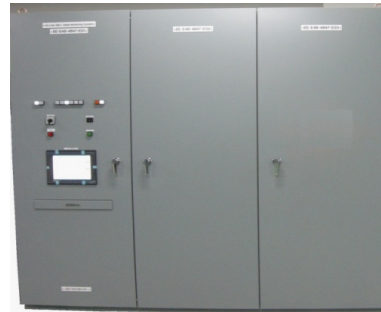
그림 4. 절연 저항을 측정하기 위한 장치 Fig. 4. Equipment to measure IR
