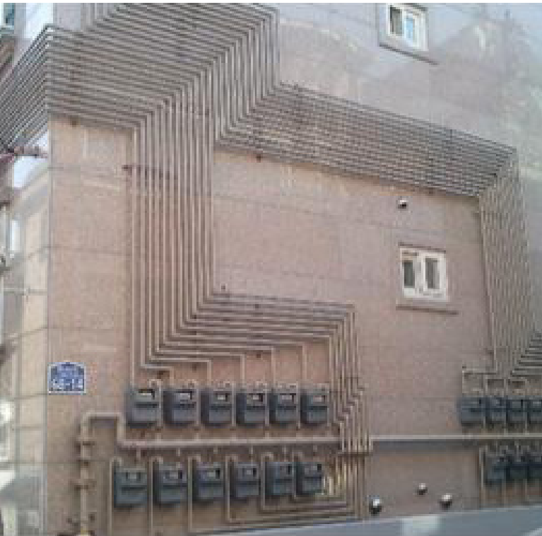
기존 외부에 노출된 도시가스 배관
