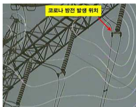
그림 8. UV 센서 어레이 시스템을 이용한 154kV 현수애자의 자외선 측정 신호 Fig. 8. UV signals of 154kV suspension insulator using UV sensor array system
